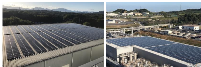
三重工場に設置した太陽光発電パネル
